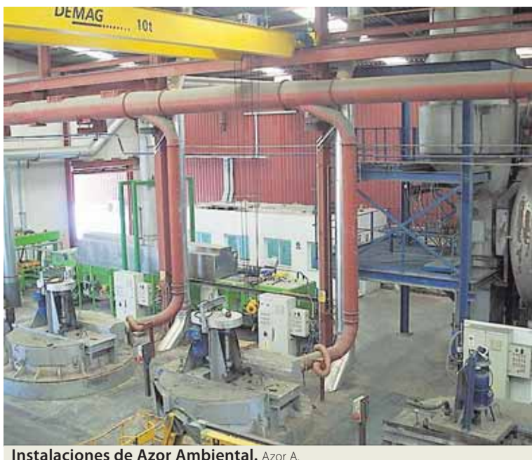
Instalaciones de Azor Ambiental. Azor A.
